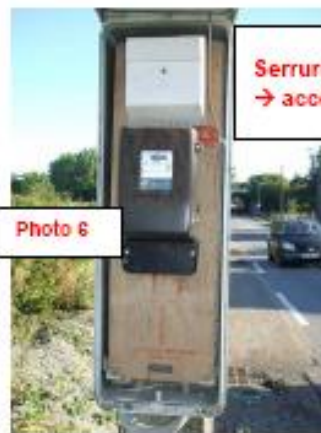
Coffret sur poteau, ouvert
