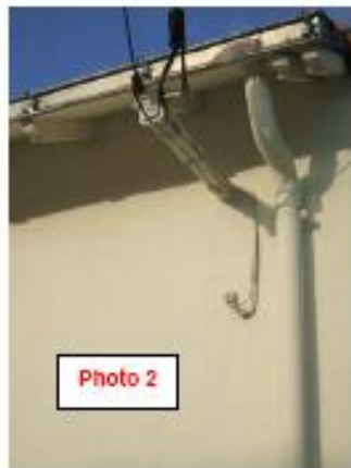
Câble de branchement, vu de près
